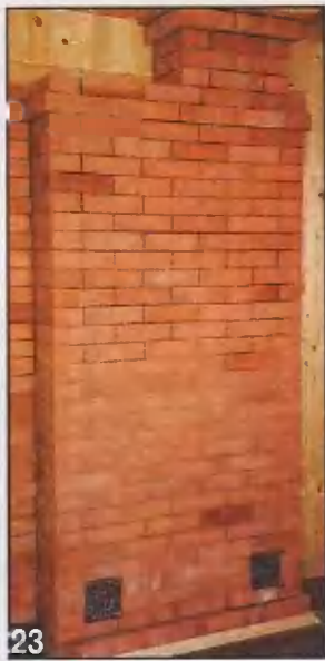
Вид с тыльной стороны печи. Внизу прочистные дверки горизонтальных дымовых каналов.
