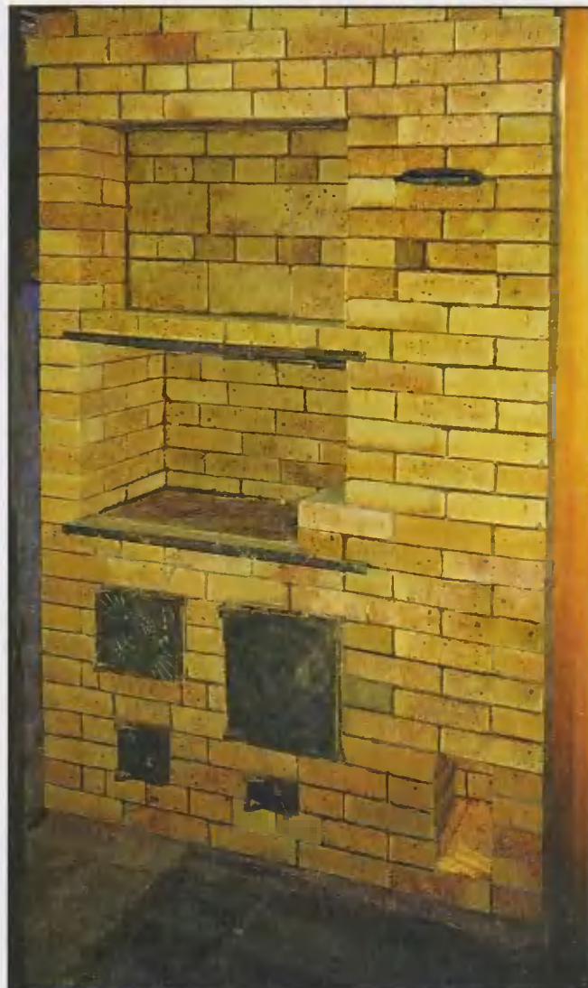
Одна из печей, построенных руками В.А. Белякова в поселке Завидово Тверской обл.
