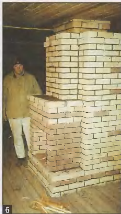
6 Отопительно-варочная печь с камином, выложенная по проекту Е. Гудкова, отделана тесаным кирпичом.
