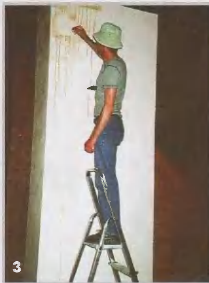
Потеки конденсата на трубе нерегулярно протапливаемой печи.
