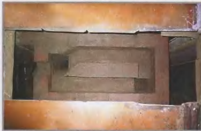
Два выворотных дымохода после колпаков первого этажа.
